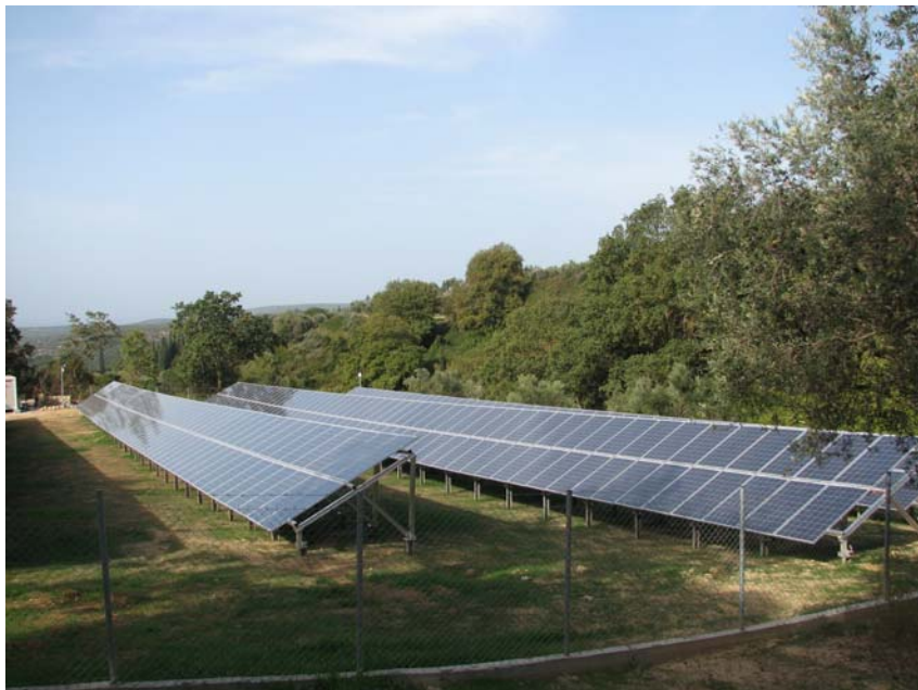
Φωτοβολταϊκός Σταθμός Παραγωγής Ενέργειας στην Πύλο Μεσσηνίας με ειδικά καλώδια TECSUN Prysmian και πίνακες χαμηλής τάσης και προστασίας από την Elesa
